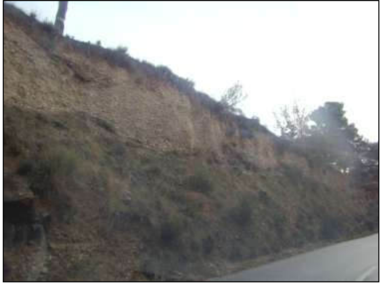
Figure 60 : Talus générant des chutes de pierres en bordure de la RD 6 [Source : IMS RN ]
