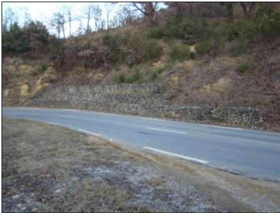
Figure 62 : Mur de soutènement en gabions le long de la RD 953, à proximité du ravin des Orgues [Source : IMS RN ]
