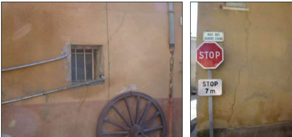
Figure 63 : Désordres sur construction dans le centre ancien [Source : IMS RN ]
