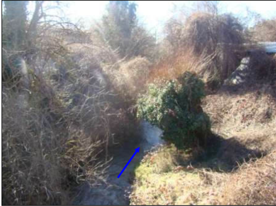
Figure 47 : L'Auvestre encombré par la végétation en amont du secteur de l'hôpital [Source : IMS RN ]
