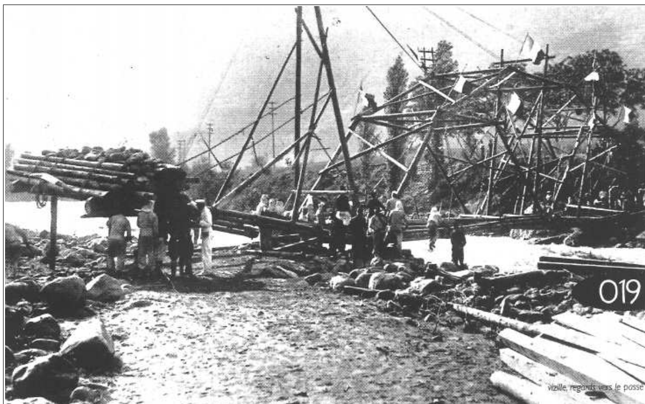
Photo 18 : Pont « Taron » construit en quelques heures au Péage de Vizille en Septembre 1911. « Vizille – Regards vers le passé » - Gérard MINGAT et Roger MORARD – 2003.
