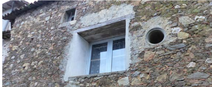
Percement d'une baie large qui ne tient pas compte de l'harmonie des ouvertures
