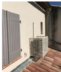
Pompe à chaleur dissimulée derrière un coffre en aluminium sur façade arrière
