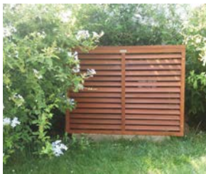
Pompe à chaleur dissimulée derrière un coffre en bois, dans le jardin
