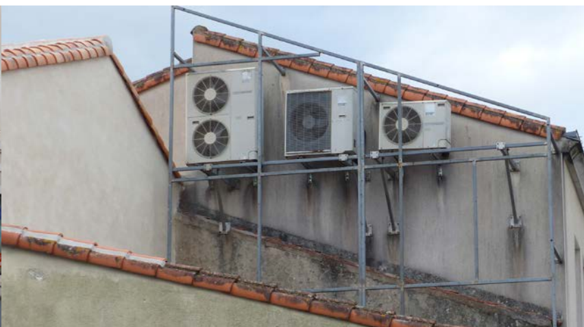
Éléments techniques (pompes à chaleur notamment) visibles en façade
