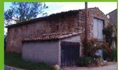
A ÉVITER : extension en blocs béton non enduit.
