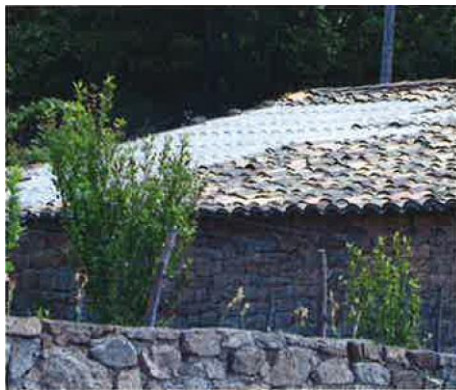
Mélange de tuiles et de tôle, réparation "discutable."
