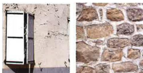
Revêtement ou joints étanches sur maçonnerie de pierre. L'humidité reste captive dans le mur et dégrade l'enduit.
