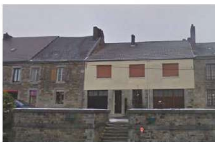
Rue Gabriel Brichet (Hargnies), percées très artificielles des tonètros réhaussées par un enduit. Les percées traditionnelles sont plutôt verticales voire carrées mais jamais horizontales.
