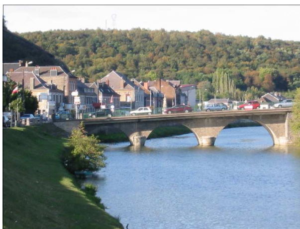
La partie en pierre du pont sur la Meuse et ses trois arcs rejoignant l'île.
