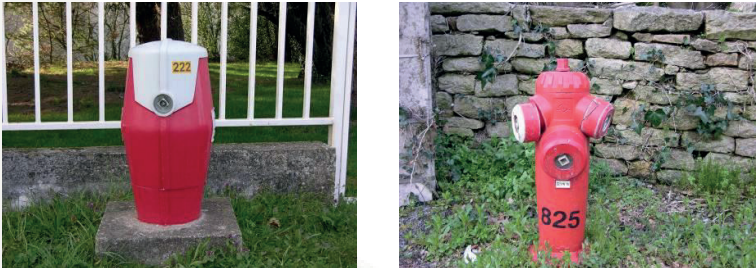
Exemples de numérotation de poteaux incendie
