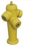
Poteau relié à un surpresseur
