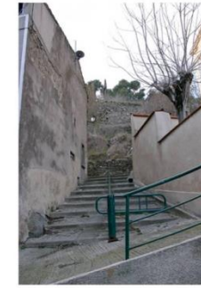
Enduit gris au ciment. Remontées d'humidité avec tâches de salpêtre (face à l'ancien presbytère)
