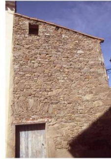
Maçonnerie apparente en moellons. Linteau en bois soulagé par un arc de décharge (12, rue des Monts Lauriers)
