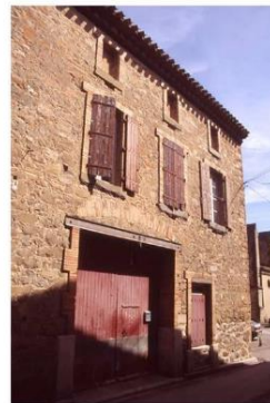
Cave avec profilé métallique soulagé, parc un arc de décharge en moellons (2, rue des Monts Lauriers)
