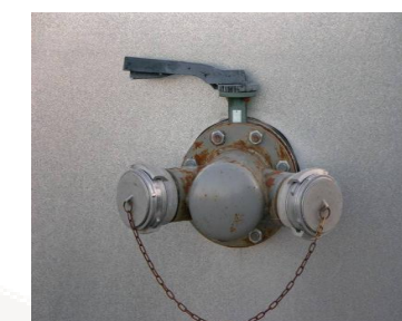
Prises directes de 100 mm sur réserve
