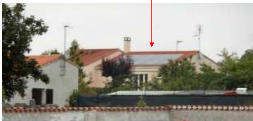
Toiture près du cimetière équipée de panneaux solaire pour l'ECS
