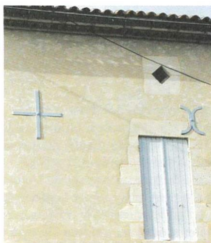
Enduit de chaux aérienne et de sable sur moellons, venant se raccorder exactement au niveau des pierres de taille
