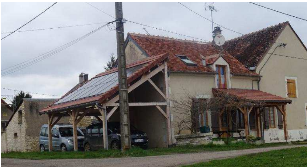
Photo : Panneaux solaires en toiture au lieu-dit « Le Brignon » à Cornusse (source : Biotope, février 2017).
