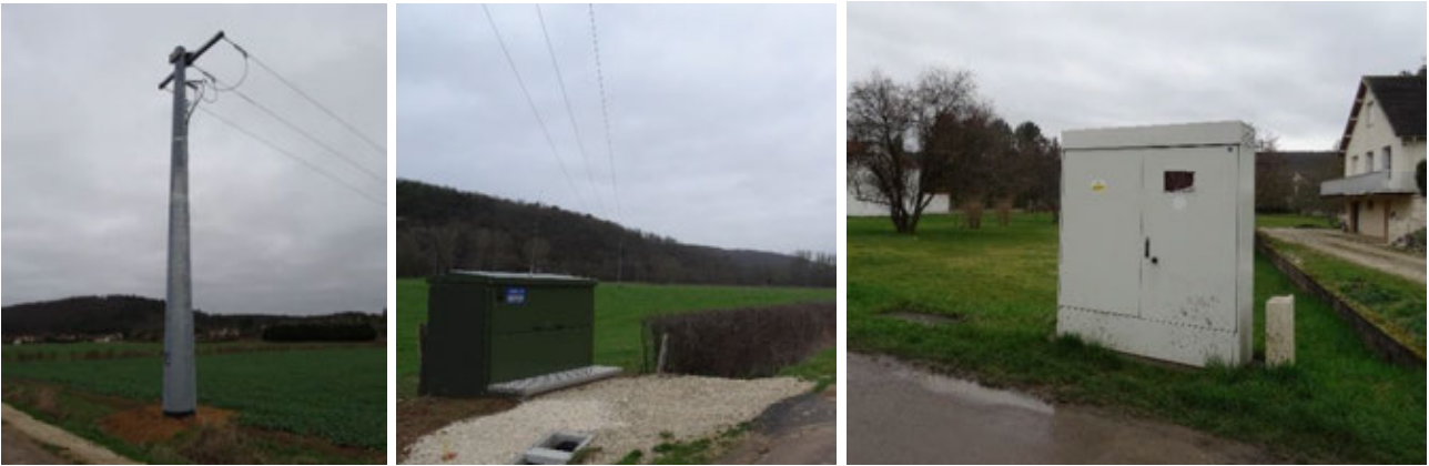
Photographie 76 - Lignes et installations électriques dont la mauvaise intégration participe à une dégradation progressive des paysages à Blannay et à Arcy-sur-Cure – vallée de la Cure
