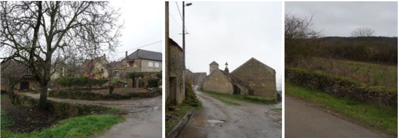
Photographie 145 – Dégradation progressive des murets de pierre sèche, petit patrimoine à Fontette et muret à Asquins
