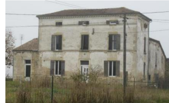
Remplacement systématique des menuiseries, selon une partition inappropriée (porte tiercée, absence de traverses)
