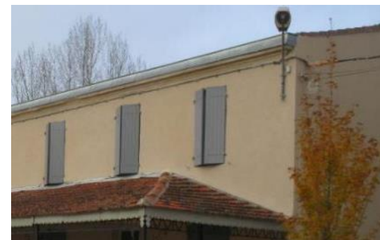
Enduit couvrant (Aillas)
