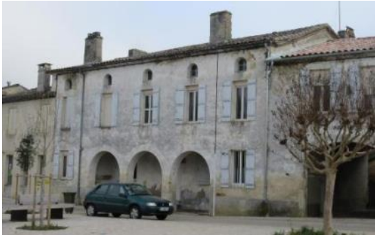
Menuiseries inappropriées : volets roulants empiétant sur la hauteur de la baie, absence de petits bois
