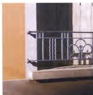
Différence de couleur et de texture entre l'encadrement de baie et l'enduit de façade
