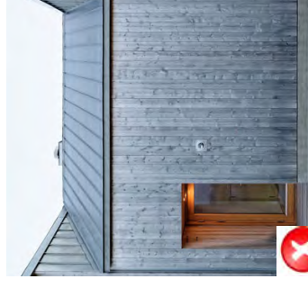
Façade bois : Végétalisation à proscrire
