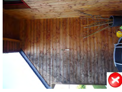
Mauvaise pratique : Façade grisée car non protégée sur une face du ruissellement d'eau de pluie.
