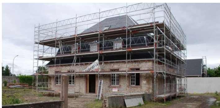
Widensolen - chantier de réhabilitation de la maison de Jean-Ulrich Metzger. Maison en maçonnerie à toiture à la française à croupes. 1ère moitié du XIXème siècle
