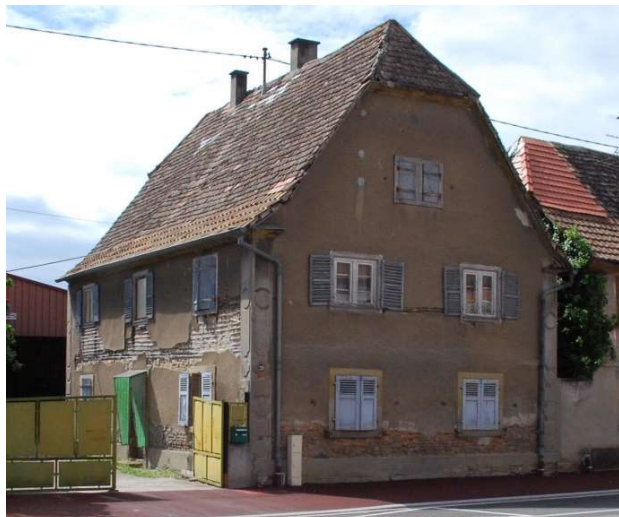
Fessenheim : maison traditionnelle en mauvais état, mais riche d'enseignements. Le rez-de-chaussée est en maçonnerie de briques, l'étage en pan de bois recouvert de crépis sur lattis. La charpente d'origine a conservé le coyau traditionnel. Elle présente un abattant de toiture. XIXème siècle.
