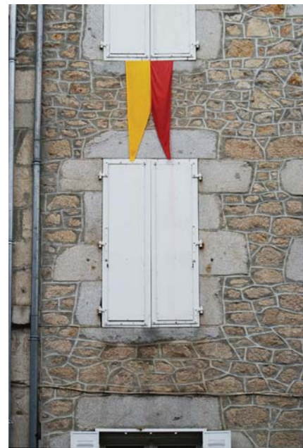
La pire des solutions, du point de vue technique comme du point de vue visuel, le rejointoiement au ciment. On risque ainsi d'entraîner des dégradations irréversibles.
