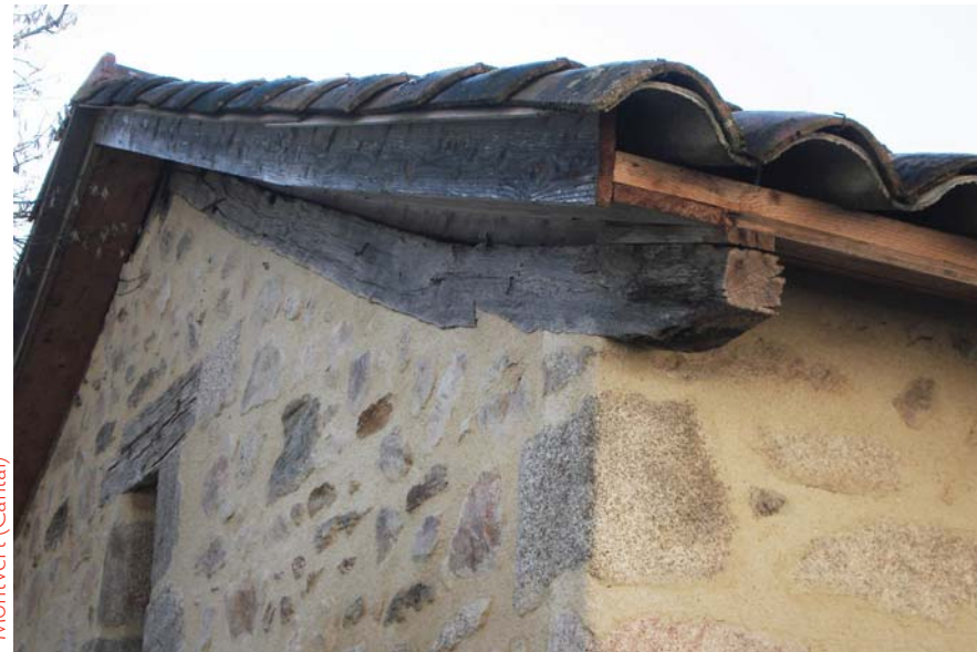
Pose de tuiles anciennes sur forme ondulée (on distingue la forme plus claire sous la tuile): l'illusion est presque totale. Il existe plusieurs toitures de ce type à Laroquebrou, peu facile à détecter.
