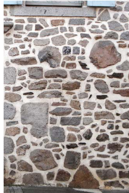
Sur cet immeuble de 1909, le décrépiage abusif a conduit à un aspect en "peau de lézard" caricatural, accentué par des matériaux différents.
