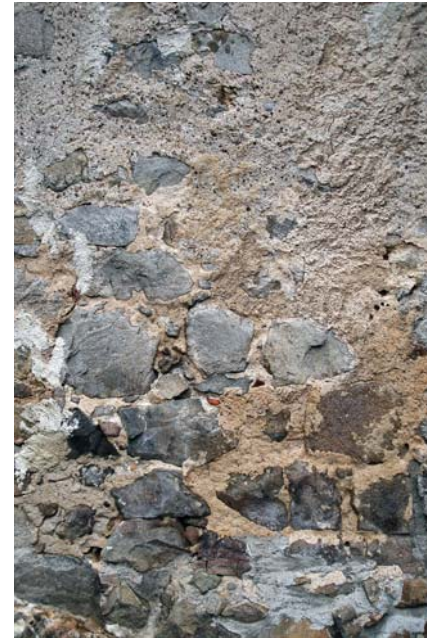
Maçonnerie ancienne érodée, dont l'enduit révèle les moellons. Noter le sable avec particules noires d'origine volcanique.
