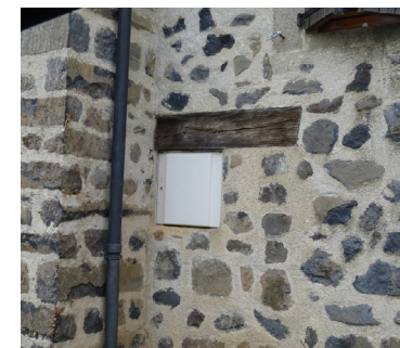
Coffre EDF intégré en façade
