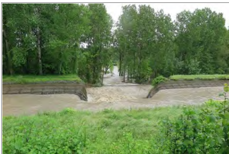
8 – Rupture du canal de Briare le 31 mai 2016, Bief de Montambert, Commune de Montcresson – Source : inforisques.loiret.fr
