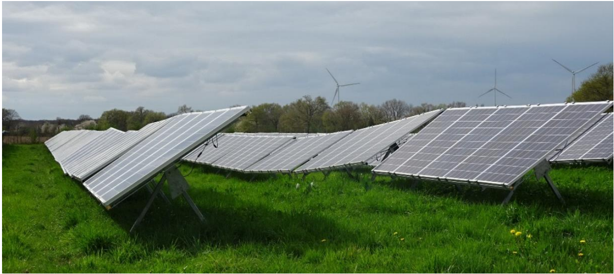
Figure 15 : Ferme photovoltaïque de Saint-Secundin – Les Plantis
