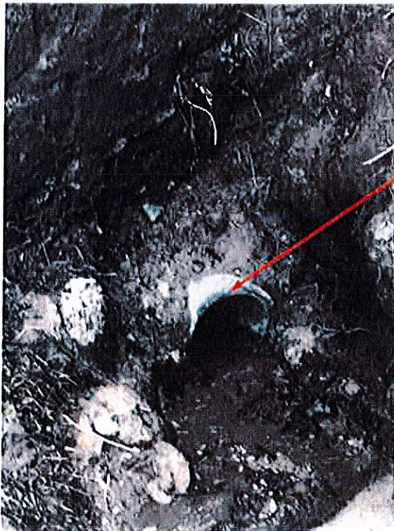
Tuyau de 300 mm se trouvant sous l'ancienne écurie et largement suffisant pour le passage de l'eau provenant de la source.
