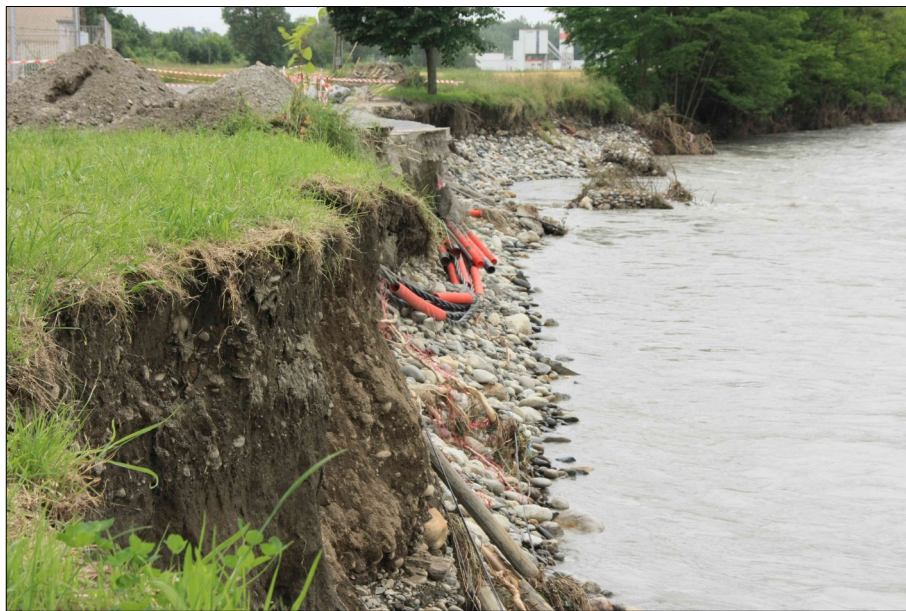
Figure n° 17 : commune de Valentine, lors de la crue du 19 juin 2013, une partie de la rue du château d'eau a été emportée au droit du dépôt EDF.
