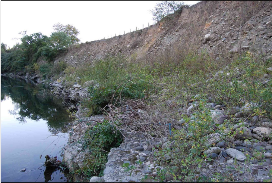
Figure n° 19 : commune d'Ausson, une partie du chemin communal a été emportée au nord du bourg d'Ausson.
