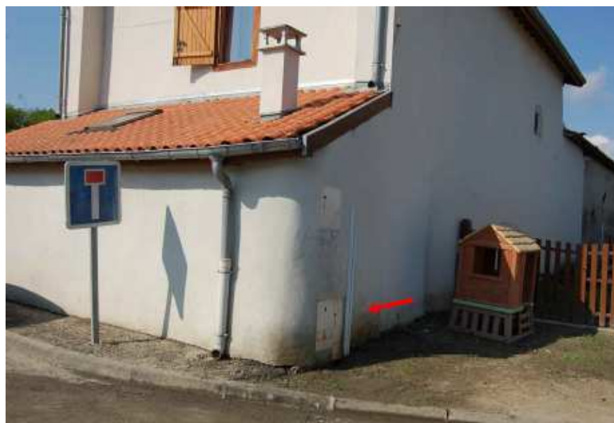
Photo n° 1 : Commune d'Ausson, n°6 rue de l'Eglise. Trace de laisse de crue sur le mur de la façade (0.35 m au-dessus du terrain naturel).
