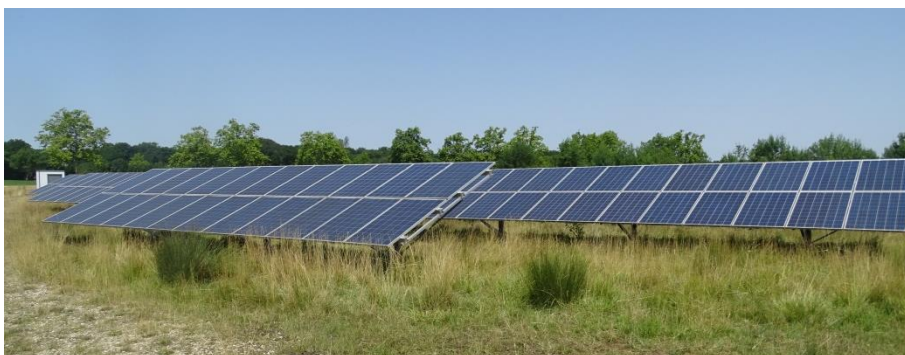
Photo 7 : Centrale solaire de L'Isle en Dodon – Source : EVEN Conseil
