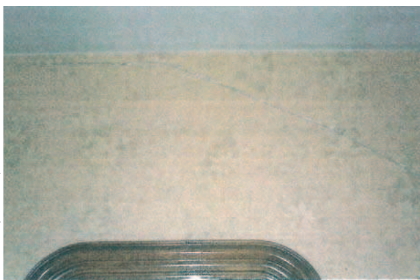
Fissuration intérieure, tapisserie déchirée - Maison André.
