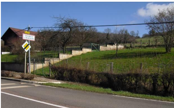
Mur avec redent non similaire aux murs anciens.
