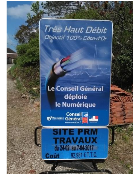
Photographie 13 : Panneau du Conseil Départemental pour la fibre optique
