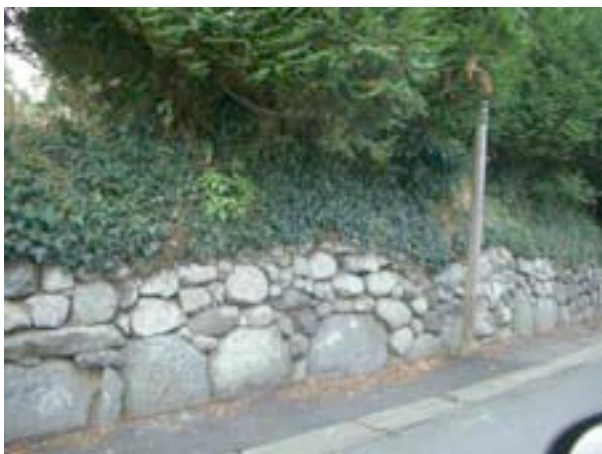
Rue des Dolmens Murs et Talus
