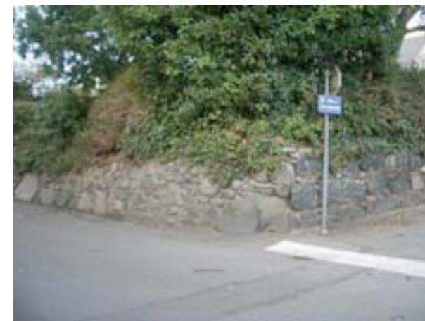
Rue des Dolmens Murs et Talus
