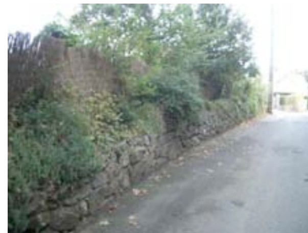
Rue des Dolmens Murs et Talus
