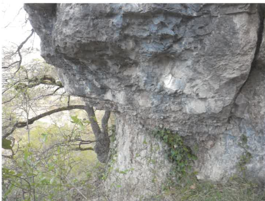
Figure 58 : Aléa 12 détail du pied fracturé (Cim)
