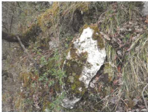
Figure 41 : Eléments à purger à côté A2 (Cim)
