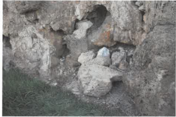
Figure 36 : Pierres et blocs sur la vire (Cas)
