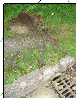
Au sud du bassin versant, sur le côté est de la route, les eaux de ruissellement d'une partie de la voirie sont collectées vers un réseau qui n'est pas relié au reste du réseau du bassin versant. Ce linéaire de réseau a pour exutoire le fossé de la route de Pompillo. Nous pouvons noter le mauvais état général de ce tronçon (réseau apparent, avaloir et grille encombrés).
