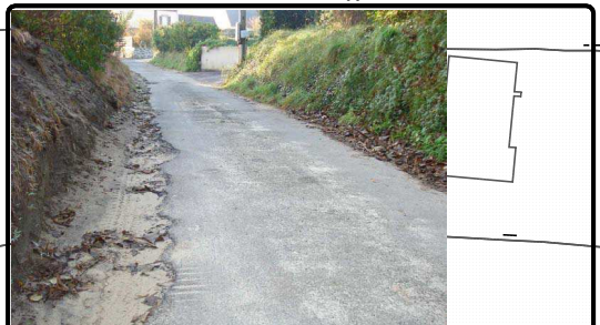
Chemin communal : la pente est marquée, il n'existe pas de réseau pluvial. Le ruissellement creuse le bas côté, et la voie régulièrement ensablée.
