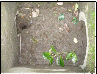
Un avaloir est complètement obstrué. Un nettoyage permettrait une meilleure évacuation des eaux pluviales.
