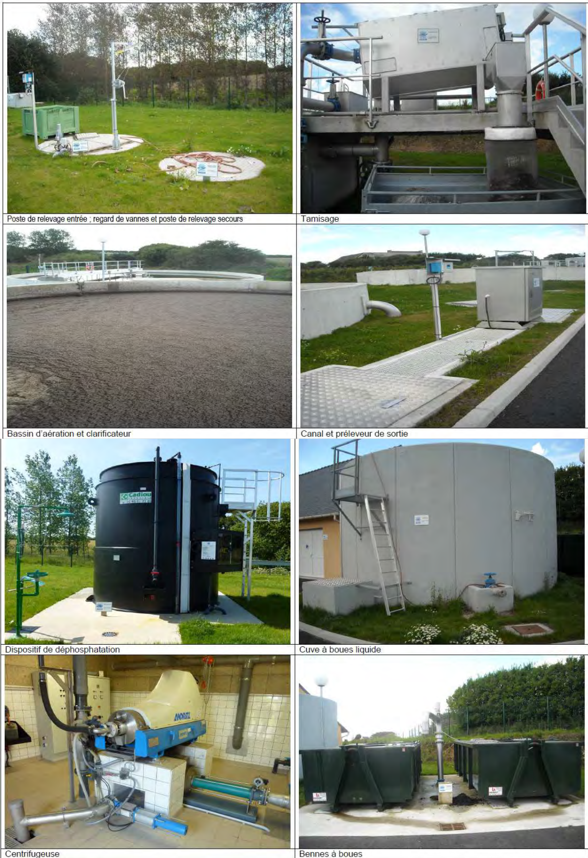
Figure 13 Photographies des ouvrages dans la station d'épuration de Saint-Thonan
