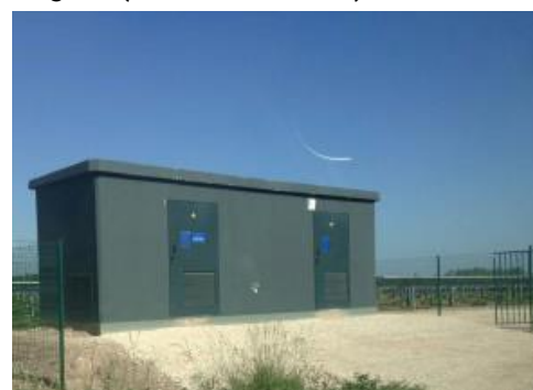
Poste de livraison
