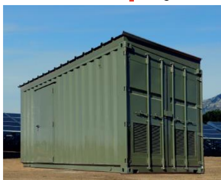
Local de maintenance
