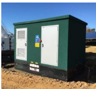
Poste de transformation
