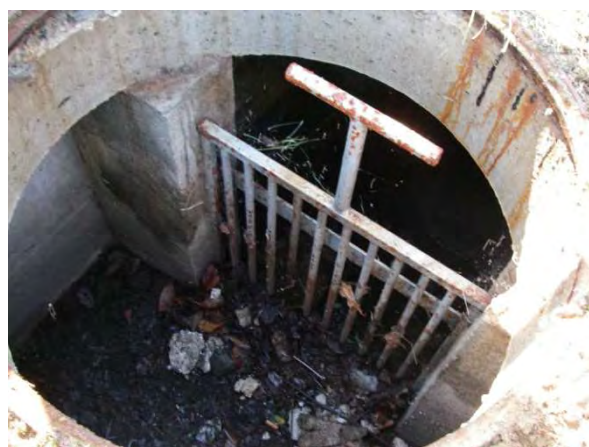
Entretien de l'ouvrage de régulation
