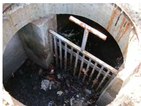
Entretien de l'ouvrage de régulation
