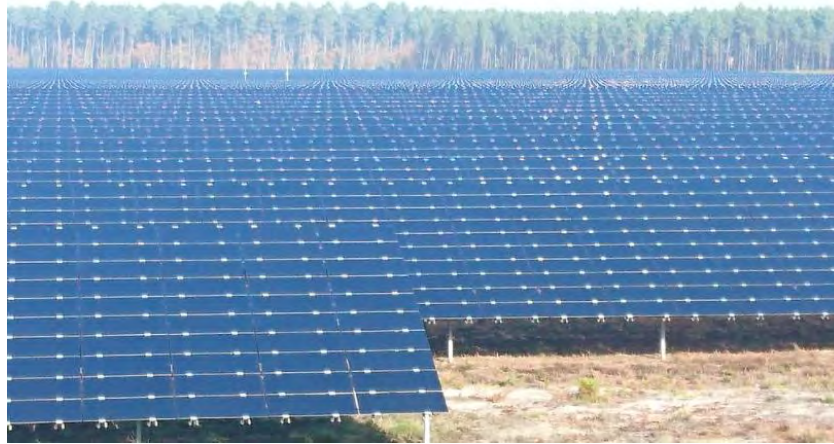
Centrale photovoltaïque au sol de Castets
