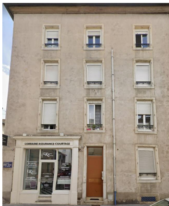
Menuiseries bois remplacées par des modèles standard en PVC ; volets roulants installés ; volets ou persiennes d'origine disparus, malgré le maintien des gonds ; grande porte à imposte remplacée ; devanture de qualité au pied d'une façade dégradée
