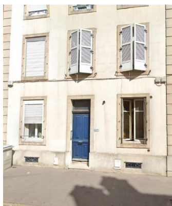
Exemple de rupture dans l'harmonie de la façade avec installation de volets roulants
