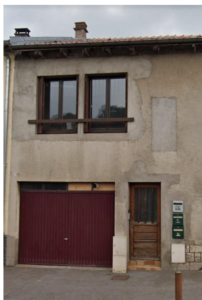
Un exemple d'altération de la qualité architecturale de la façade :
