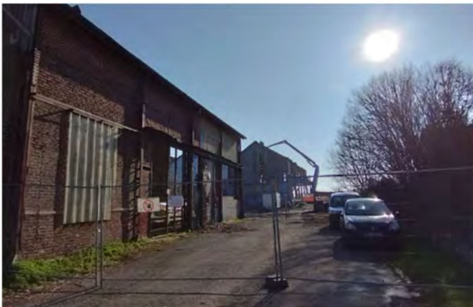
Photo 1 : Vue de la cour et des travaux de mise en sécurité des bâtiments en cours (mars 2024).
