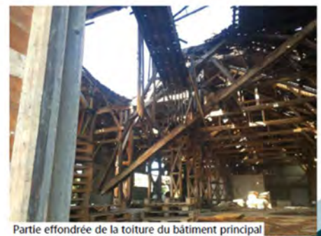
Partie effondrée de la toiture du bâtiment principal
