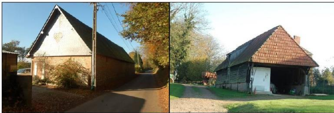
Exemples de toitures traditionnelles (en ardoise à deux pans / en tuiles de terre cuite à croupe)
