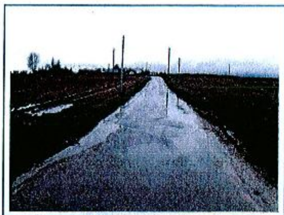
Passage d'eau sur la voirie (32)
