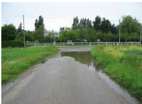
Dysfonctionnements observés rue de la Pihoudière (Source : SOGETI Ingénierie)
