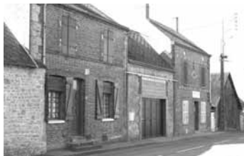
Avant : baie dénaturée (partiellement remplie en parpaings).
