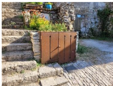
Exemples – compteur électrique
