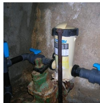
Photographie 44 - Filtre à cartouche
