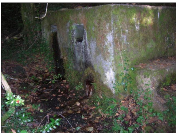
Photographie 7 - Dessableur en aval direct de la prise
