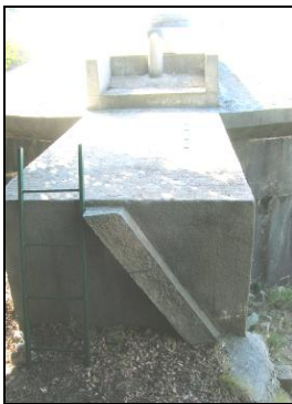
Photographie 25 - Accès par échelle non sécurisée
