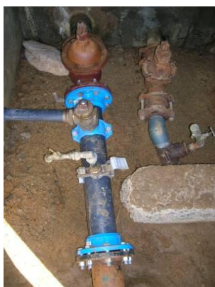
Photographie 30 - Conduite de distribution
