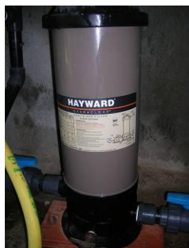
Photographie 43 - Filtre à cartouche
