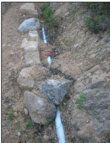
Photographie 13 -Canalisation à découvert
