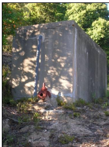
Photographie 9 - Vue du décanteur hors service
