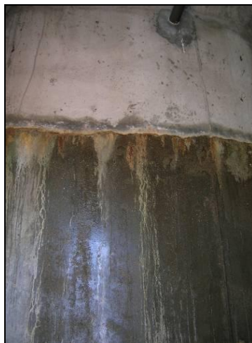
Photographie 22 - Etat du GC dans la chambre des vannes
