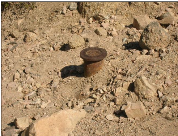
Photographie 17- Vanne en amont du réservoir
