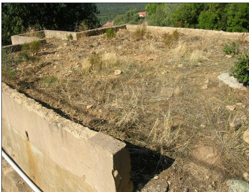
Photographie 19 - Etat du réservoir bas de MONACCIA (réserve incendie)
