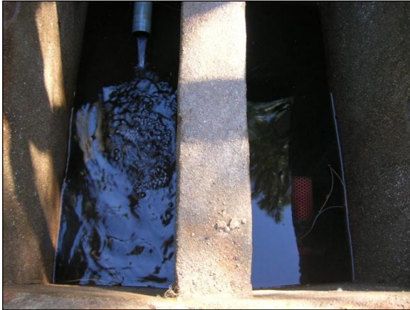
Photographie 15 - Vue générale du brise charge sur la conduite d'adduction de GIANNUCCIO
