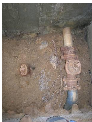
Photographie 31 - Conduite de vidange
