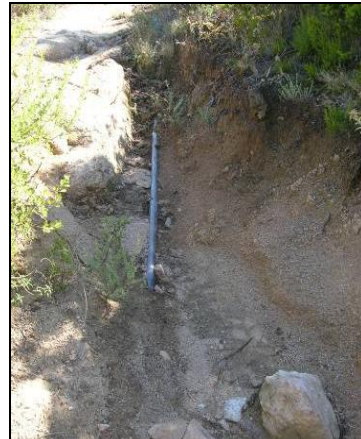
Photographie 18 - Conduite d'adduction mis à nue par l'érosion
