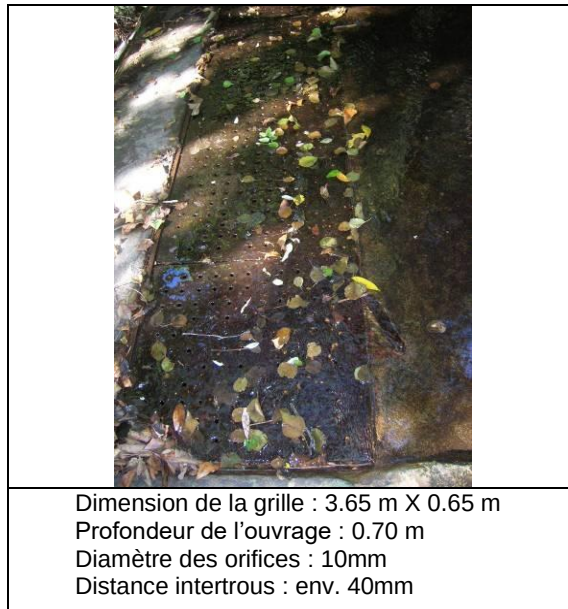
Photographie 1 - Prise d'eau en rivière de la BALATESE
