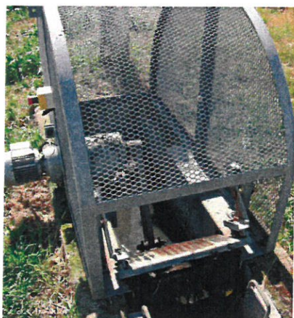
Aperçu du dégrilleur automatique
