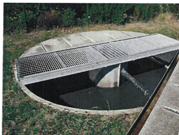
Vue du clarificateur statique
