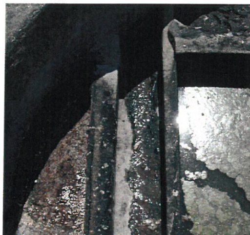
Aperçu de l'infiltration des graisses dans le canal d'évacuation
