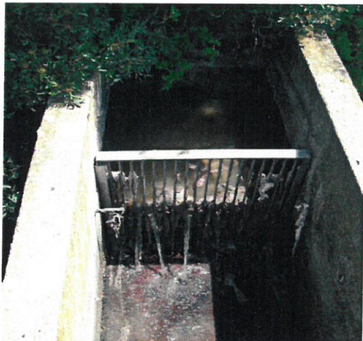
Aperçu du dégrilleur partiellement colmaté
