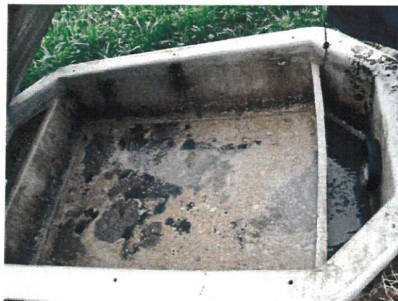
Vue du décanteur primaire
