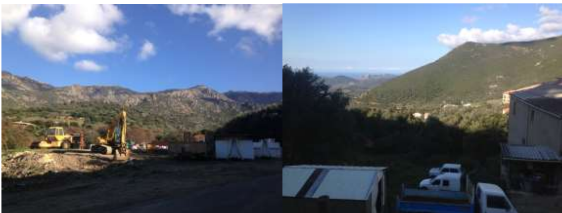
Stationnement d'engins à proximité immédiate de la route du village et stationnement de véhicule à la sortie du village sur la route menant à Lama et leur impact visuel vis à vis du contexte paysager.
