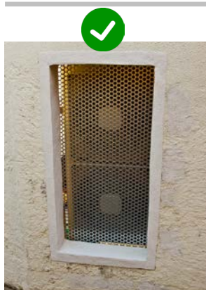
Équipement technique dissimulé derrière une grille (exemple à Sainte-Anastasie)
