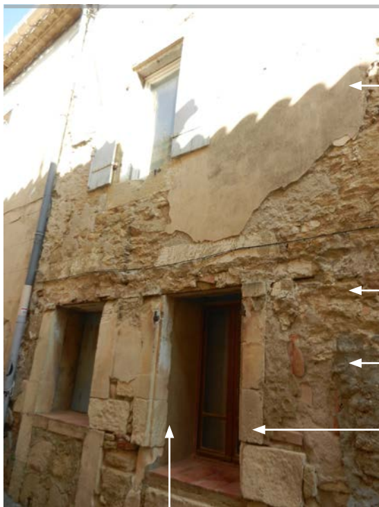
Façade enduite à rénover, Sernhac
