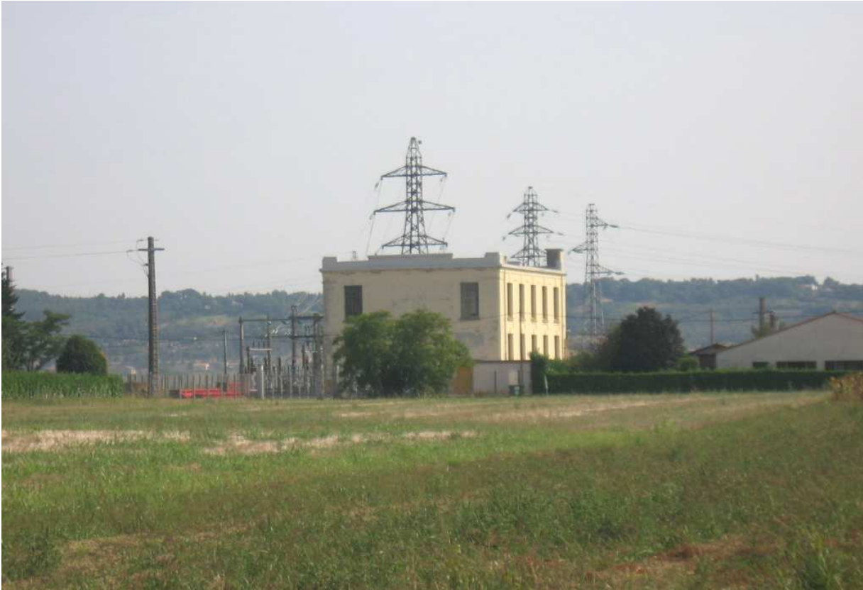
Le poste électrique à proximité du bourg, au Nord.
