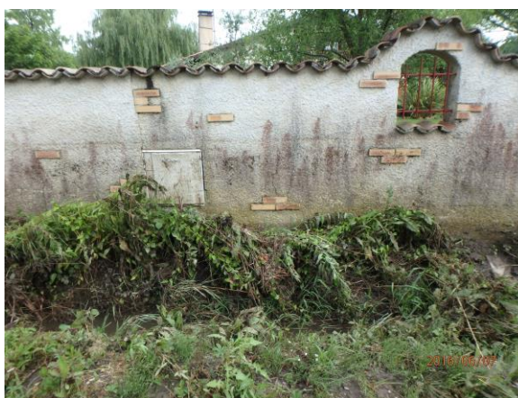
Niveau d'eau atteint Ave du Site Montesquieu
