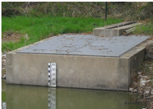
Illustration 4: Canal de comptage et dégrilleur
