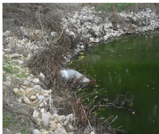
Illustration 8: Sortie de la station d'épuration
