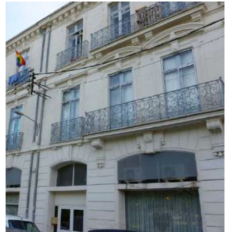
La mise en place de doubles fenêtres au nu extérieur nuit à l'harmonie d'origine
