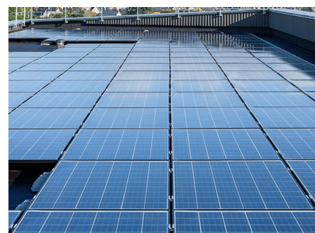
Exemple de toiture photovoltaïque avec acrotère
