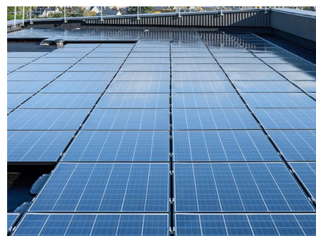
Exemple de toiture photovoltaïque avec acrotère
