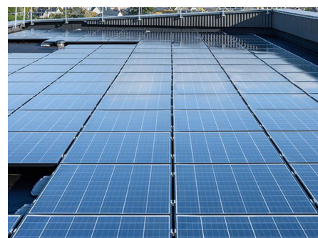
Exemple de toiture photovoltaïque avec acrotère
