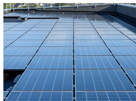
Exemple de toiture photovoltaïque avec acrotère
